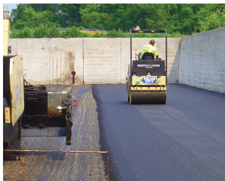
O PISO DESGASTADO de um silo trincheira de concreto pode ser recapeado com duas camadas compactadas de asfalto, totalizando cerca de 8 cm de espessura.
